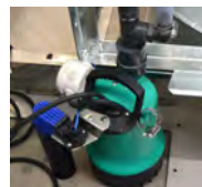
Bomba de agua WILO con interruptor de nivel.
